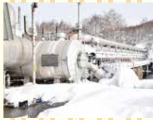
蒸気輸送管 発電所に蒸気を送ります
